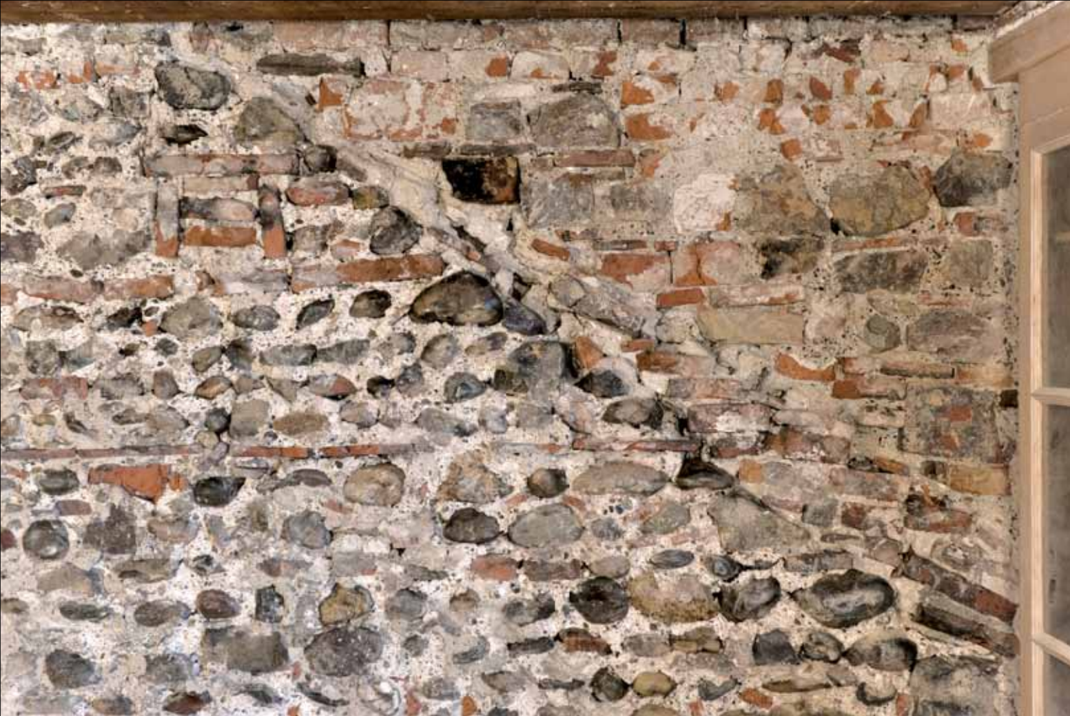
Die Dachlinie des Hauses Spalenberg 59 zeichnet sich im Mauerwerk der Brandmauer deutlich ab. Darüber die Aufmauerung, die bei der Aufstockung des Hauses 57 im Jahr 1876 erfolgte.
