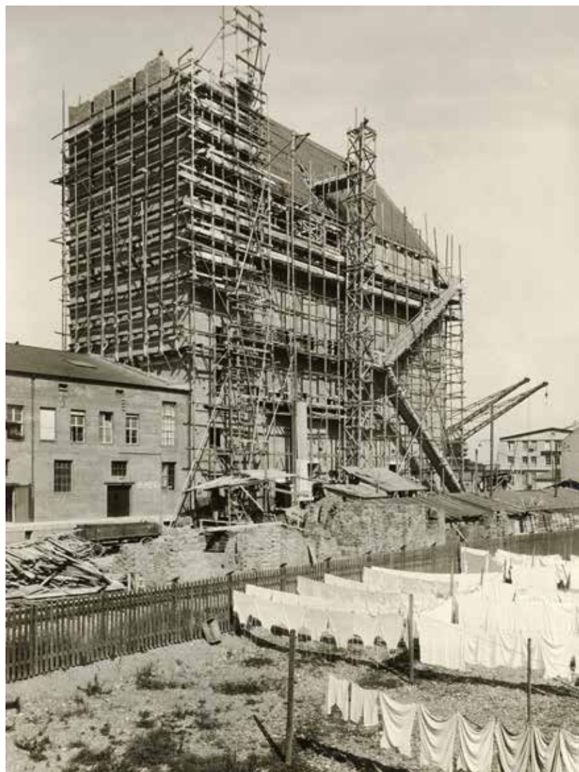
Hafenindustrie trifft auf Fischerdorf: Im Vordergrund hängt die frisch gewaschene Wäsche (Wie lang sie wohl so weiss bleibt?), während jenseits des Gartenzauns das Bernoulli-Silo in die Höhe wächst. Foto September 1925
